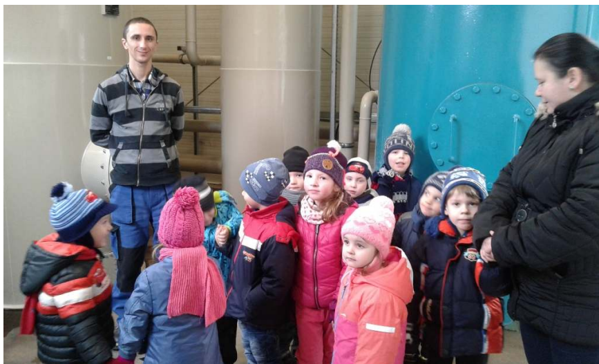
A vízmű, víztorony megtekintése
