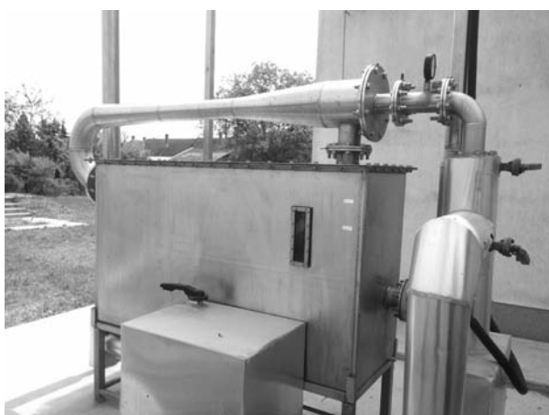
1. kép: Telepített VLV berendezés
