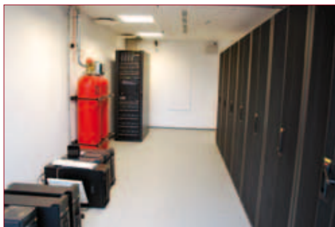
A szerverszoba egységes szerver- és hálózati szekrényekkel, baloldalt lecsereelt szerverek, a tűzoltó-berendezés gázpalackjai, a szünetmentes tápegység
