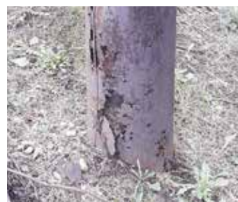
Jelentős mértékben korrodált, védelem nélküli kútfej-szellőzőcső kivezetés a talajon keresztül (a szerző saját felvétele, 2019)
