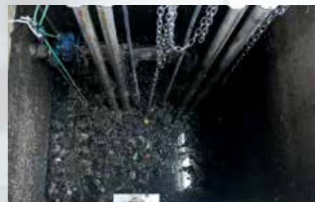
Teszt áttemelő a Flygt Concertor™ telepítése előtt.
