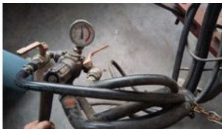
5. ábra. Armatúracsoport manométerrel és szakaszolókkal (Forrás: saját felvétel)
