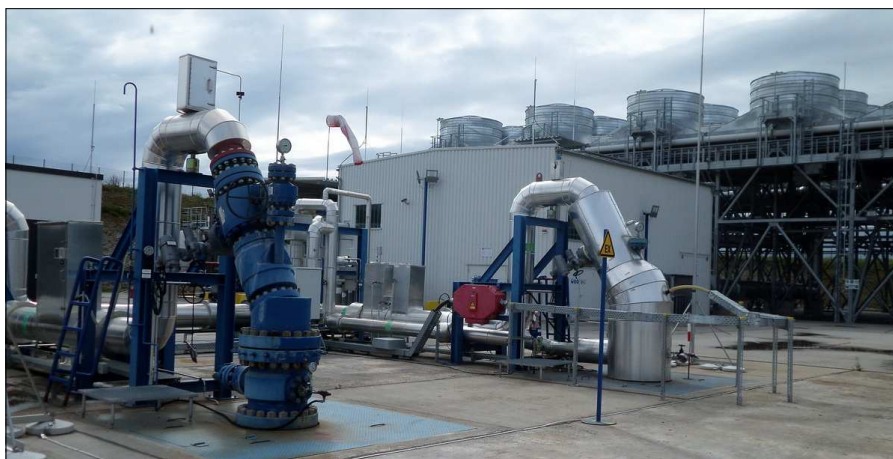
Erőművi látkép - elől balra a visszasajtoló kút, tőle jobbra a termelő kút, mögötte az ORC gépház, háttérben a léghűtésű kondenzátorok
