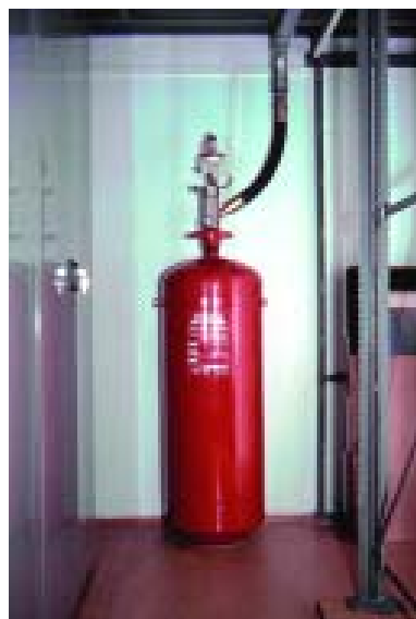
18. kép Gázzal működő, beépített, automatikus tűzoltó rendszer tartálya
